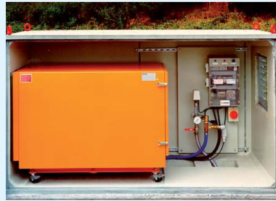
DRUCKROHRSPÜLSTATION: Bild 7 mit Kompressor zum Direktanschluss
